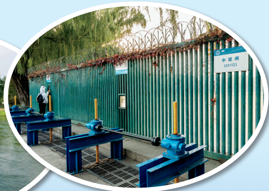
为保护水源安全，团城湖设置了3米高的钢管围栏，实行封闭管理
